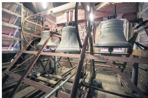
Ook in de klokkentoren is herstelwerk te doen.
